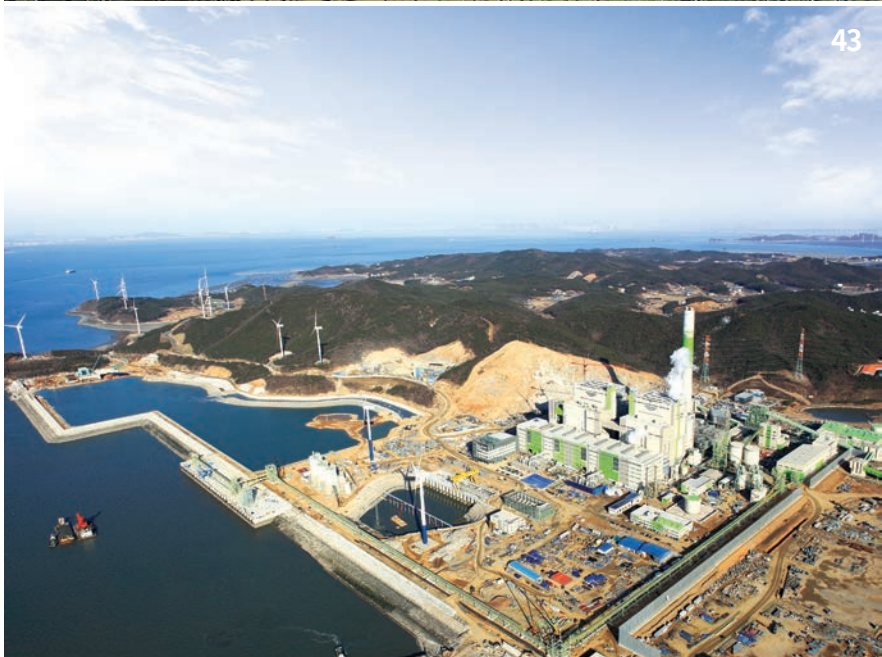
43. 영흥화력발전소(5, 6호기) 위치 : 인천광역시 옹진군 - 총발전량 1,740MW급 석탄화력발전소 - 870MW×2 (2 PC Boiler + 2ST) 공사기간 : 2011. 04 ~ 2014. 12
